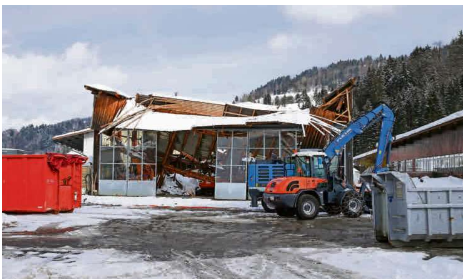
Am Freitagabend kurz nach 21 Uhr ist in Gibswil das Dach eines Transport- und Baggerunternehmens eingestürzt. Foto: Nathalie Guinand
